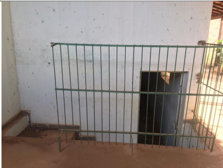
Descrição: ACESSO AO CAMARIM (SUBSOLO DO PALCO)
